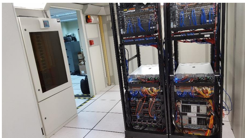
Data Center Fórum Pedro Lessa
