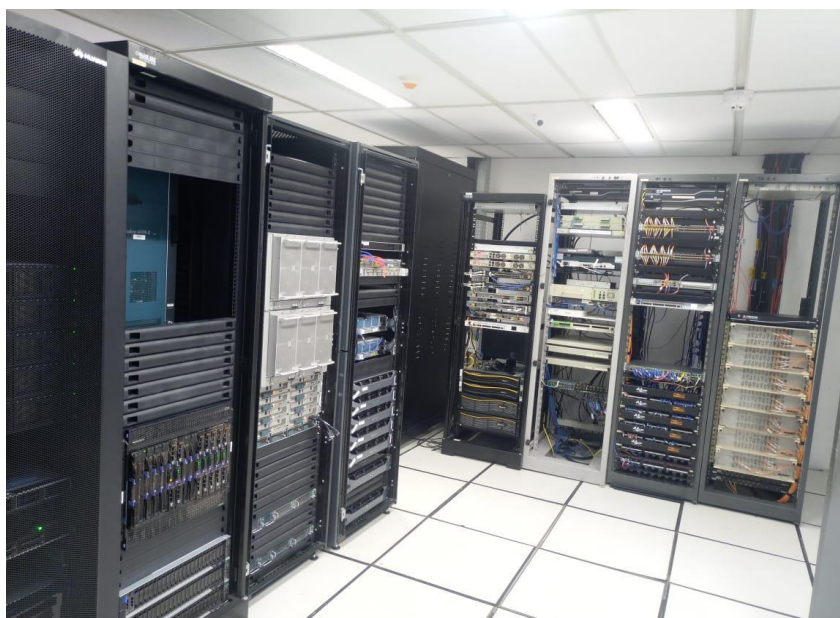
Data Center Edifício Sede
