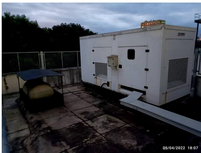
Gerador do Data Center do Prédio Sede
