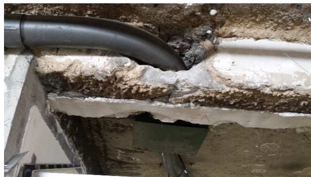
Secção indevida por tubulação na viga encontrada após retirada do forro. Deverá sofrer recuperação estrutural.
